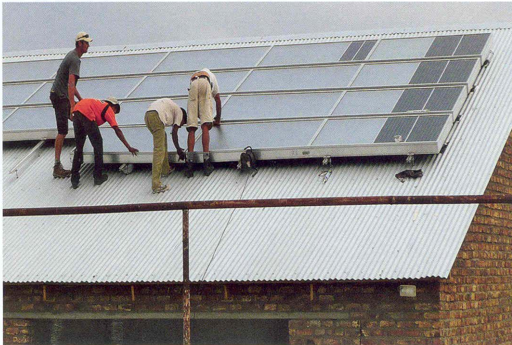
Vier Twinsolar-Kollektorreihen versorgen das Gebäude mit 1.400 m 3 /h Warmluft und beladen 1.500 Liter Speicherwasser.
